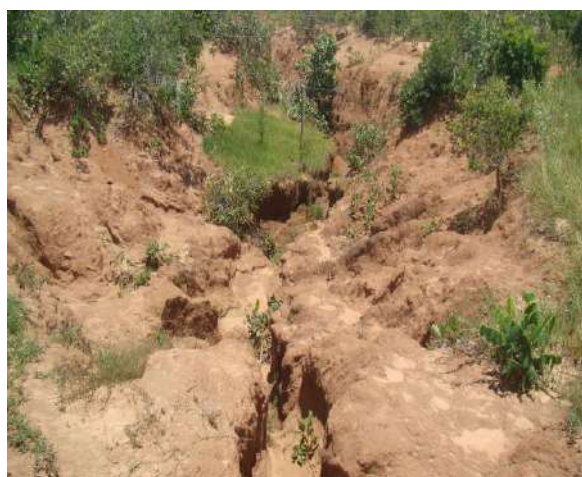
Foto - 7. Vista interna do processo erosivo PE3 no ponto da cerca da divisa com a APP.
