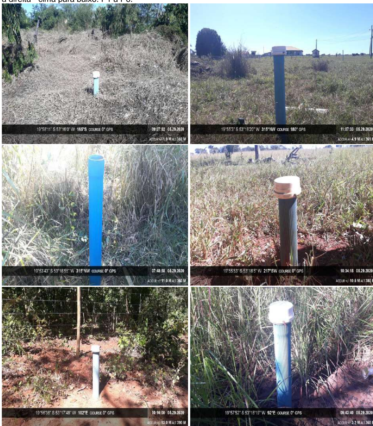
Figura 2 - Poços de monitoramento da PCH Verde 4 na campanha de maio de 2020. Da esquerda para a direita - cima para baixo: P1 a P6.
